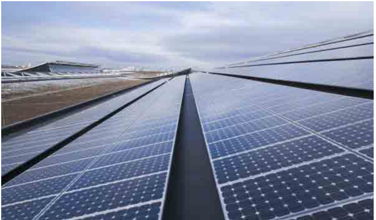
Il nuovo centro fiere di Stoccarda: l'impianto fotovoltaico sul tetto è tra i più grandi del mondo.
